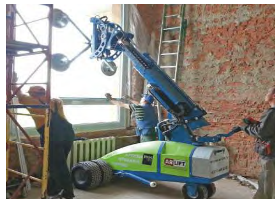
Остекление внутри помещений
